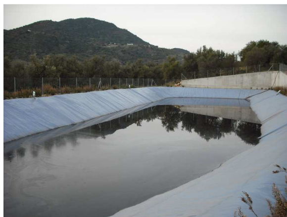
Figura 1. Balsa de alpechín con revestimiento de polietileno.
